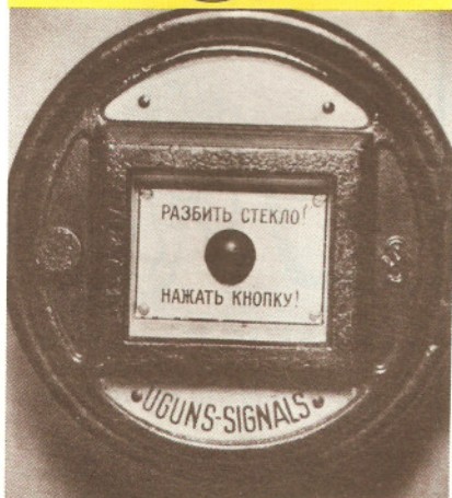
Požární signalizace. Azbuka vedle lotyšské latinky.
